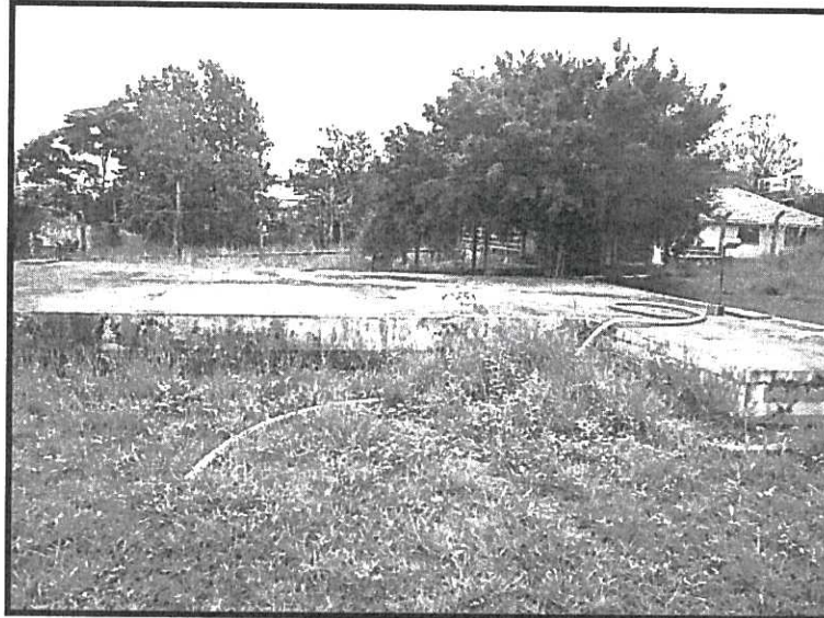
Figura 49 - Reservatório Enterrado ETA Ana Helena (200 m³).
