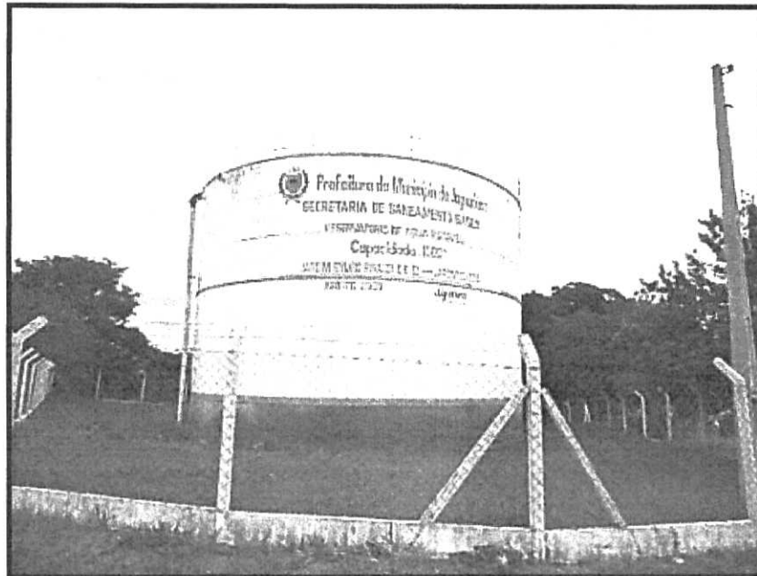
Figura 37 - Reservatório Sylvio Rinaldi I (1.000 m 3 ).
