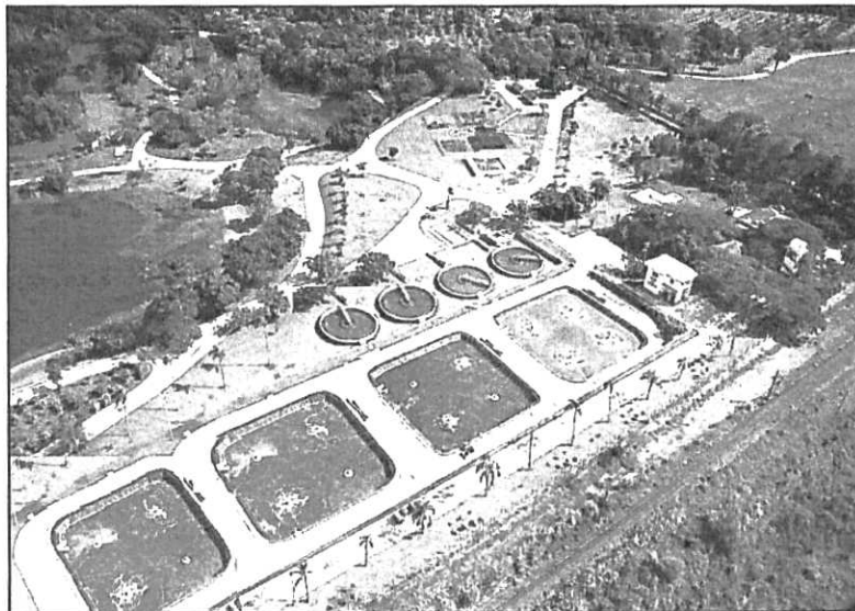
Figura 71 - Vista aérea da Estação de Tratamento de Esgoto Camanducaia.
