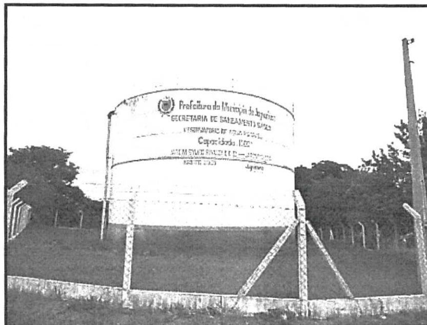
Figura 37 - Reservatório Sylvio Rinaldi I (1.000 m 3 ).
