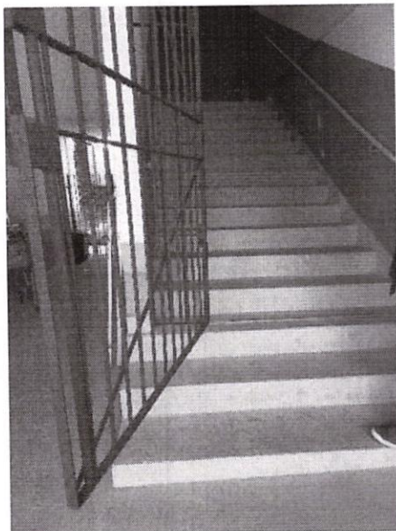
Falta de acessibilidade
