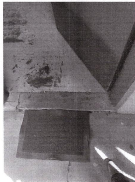
Falta de soleira
